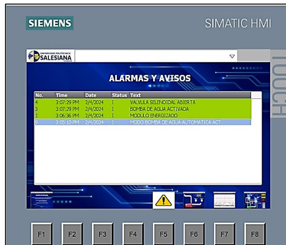
Fig. 50.- Alarmas y Avisos en funcionamiento
