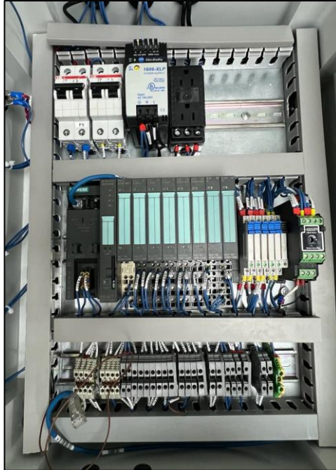
Fig. 5.- Sistema Industrial Para Control De Llenado
