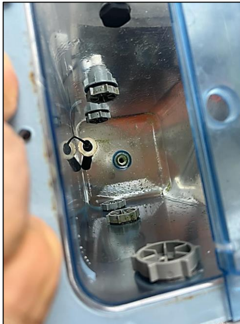
Fig. 12.- Presencia De Moho En Tanque
