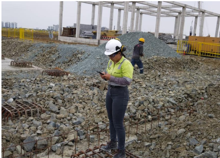
Imagen 4. Revisión estado de acero para Clarificador
