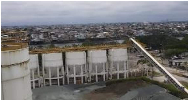
Imagen 9. Silos de Almacenamiento de Agregados
