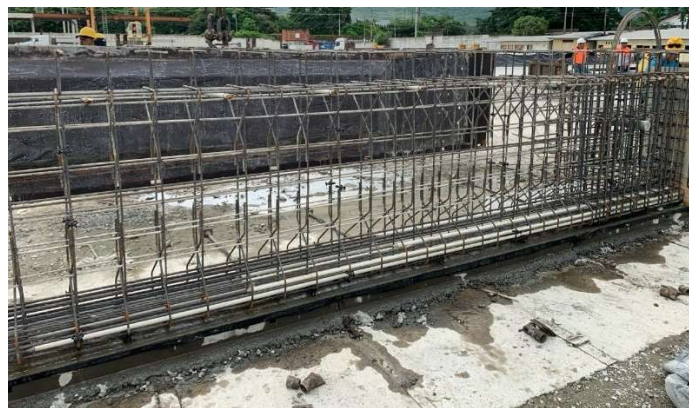
Ilustración 14. Desadherencia de torones.
