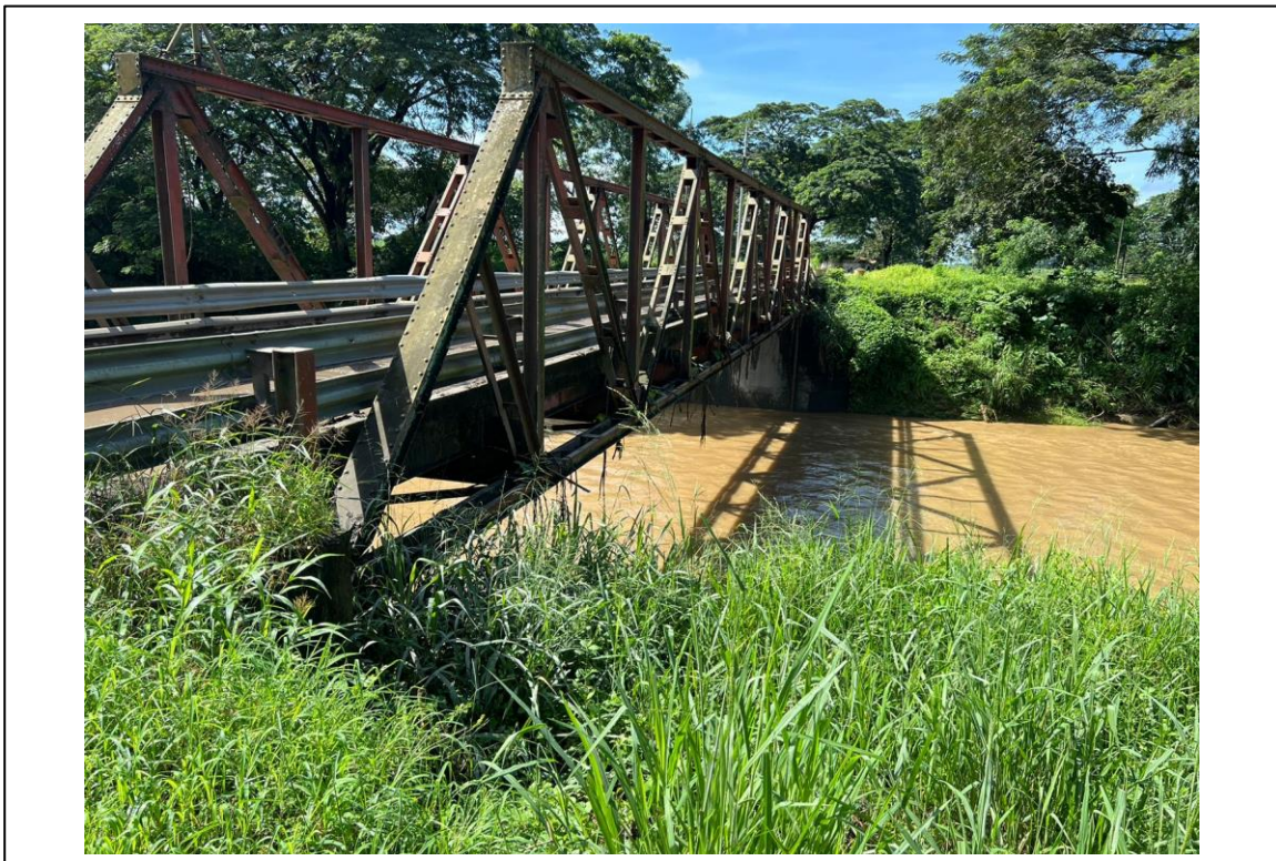
Imagen 1. Estado actual del canal y puente en el rio Barranco Alto
