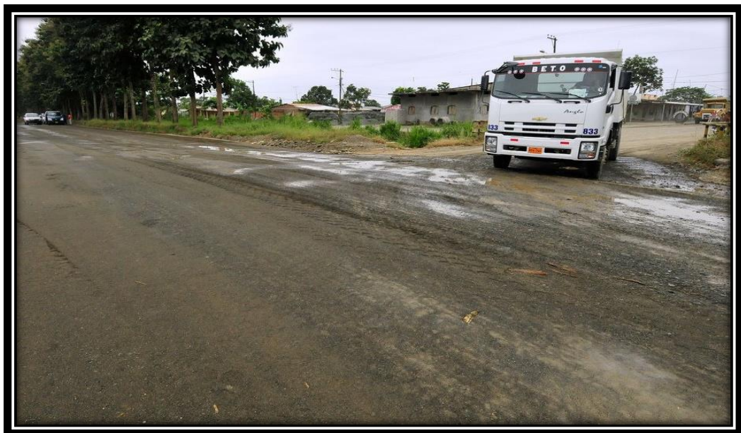
Ilustración 3 Estado de la Vía
