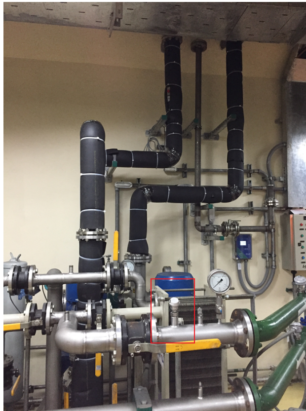
Figura 4.4: Instalación de RTD con termopozo en el intercambiador de calor. Fuente: Autor
