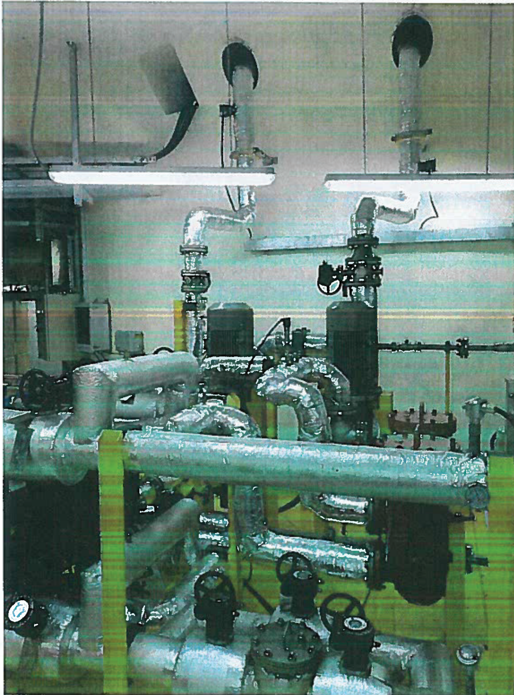
图 4-3 推力冷却水测量管路及外循环油管路外包隔热材料
