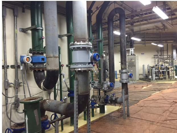
Figura 4.3: Instalación de caudalímetros para medición de la eficiencia en sitio. Fuente: Autor
