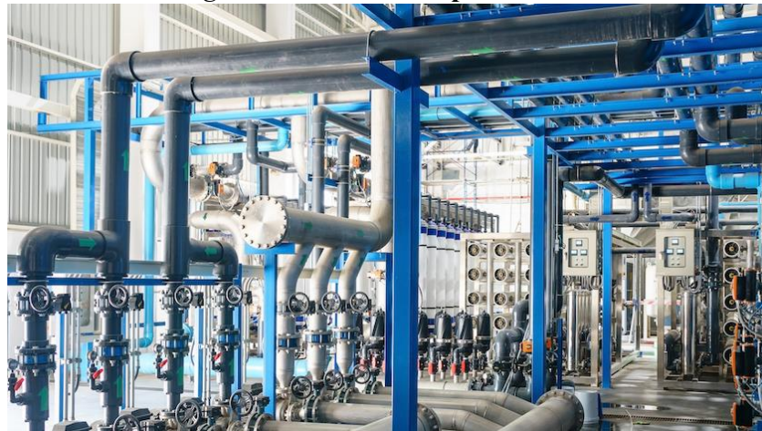
Figura 9: Tuberías de presión
