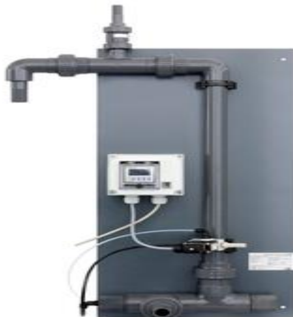
Figura 10: Tubería no presurizada
