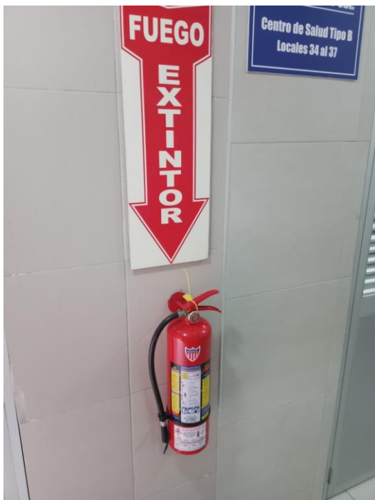
Anexo 26 Extintor ubicado en el área de almacenamiento intermedio.
