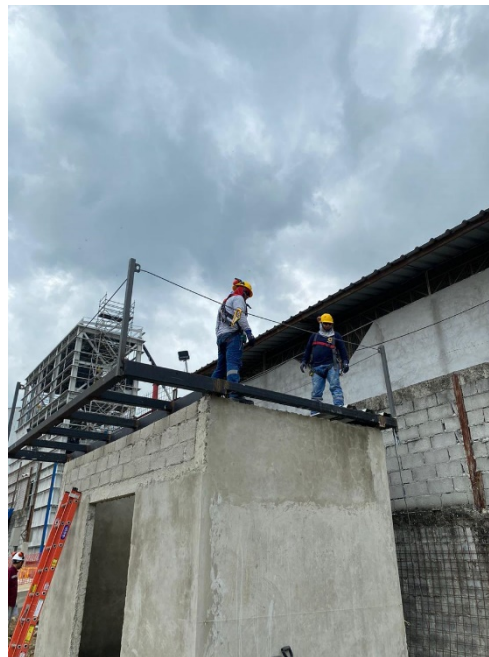
Figura 44. Colocación de plancha kubilosa para armado de encofrado y fundición de losa con la ayuda de línea de vida, grilletes y retráctiles certificados con ficha técnica de la resistencia de cada equipo.
