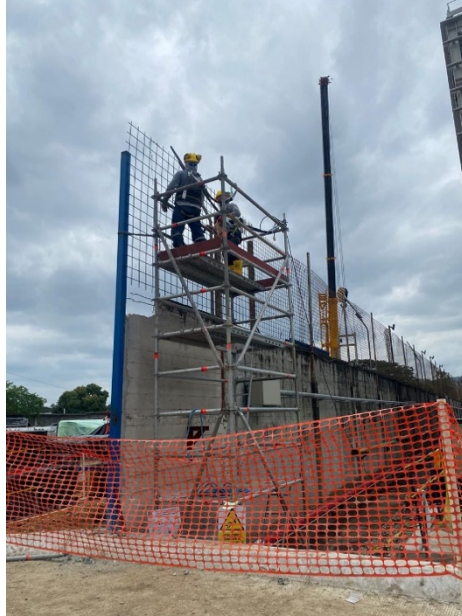
Figura 45. Posicionamiento de malla de cerramiento con ayuda de andamio unidimensionales, arneses y eslingas
