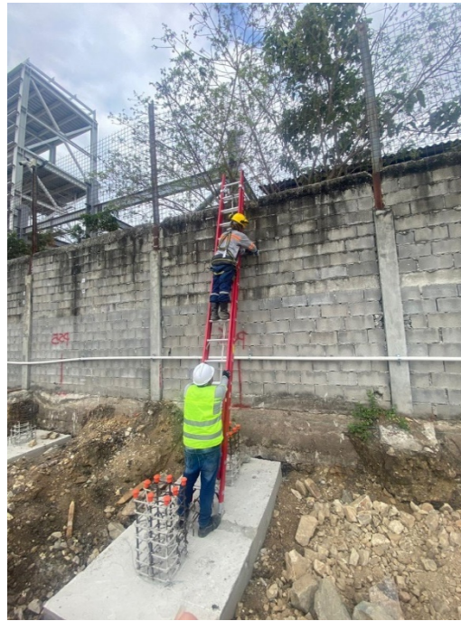
Figura 43. Colocación de ménsulas con ayuda de escalera telescópica certificada y previo inspeccionada amarrada a malla fija
