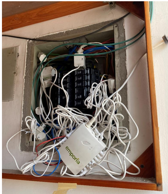
Figura 3: Instalación de equipo de medición "Emporia Gen 2".
