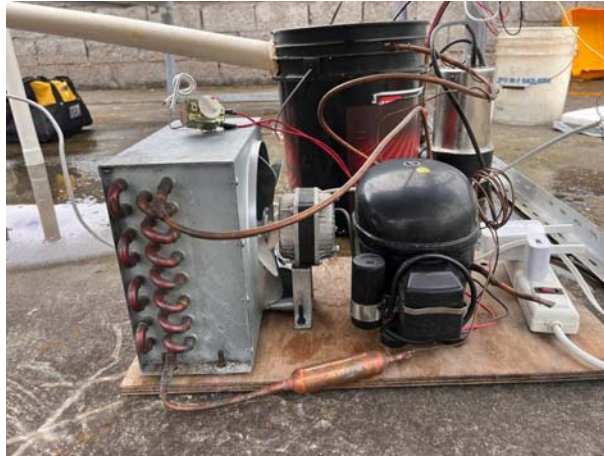
Figura 3.21: Montaje del Sistema Chiller.
