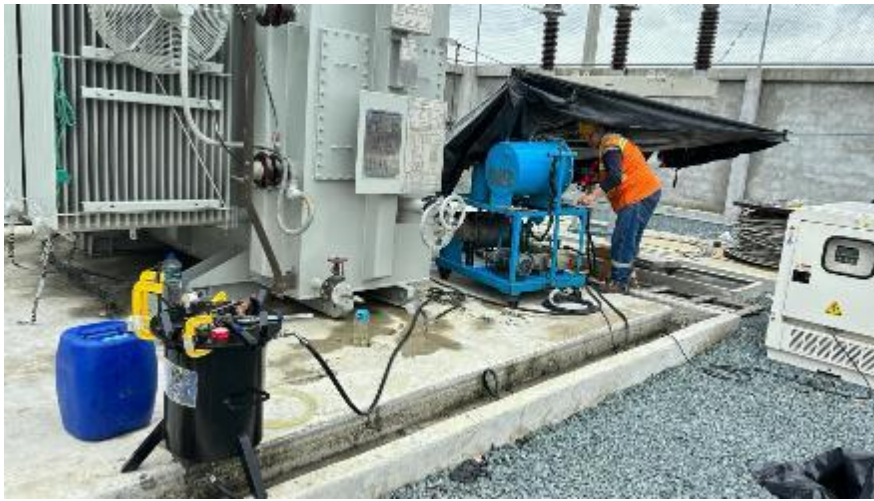
Figura 41.- Ultimo proceso de recirculación y filtrado
