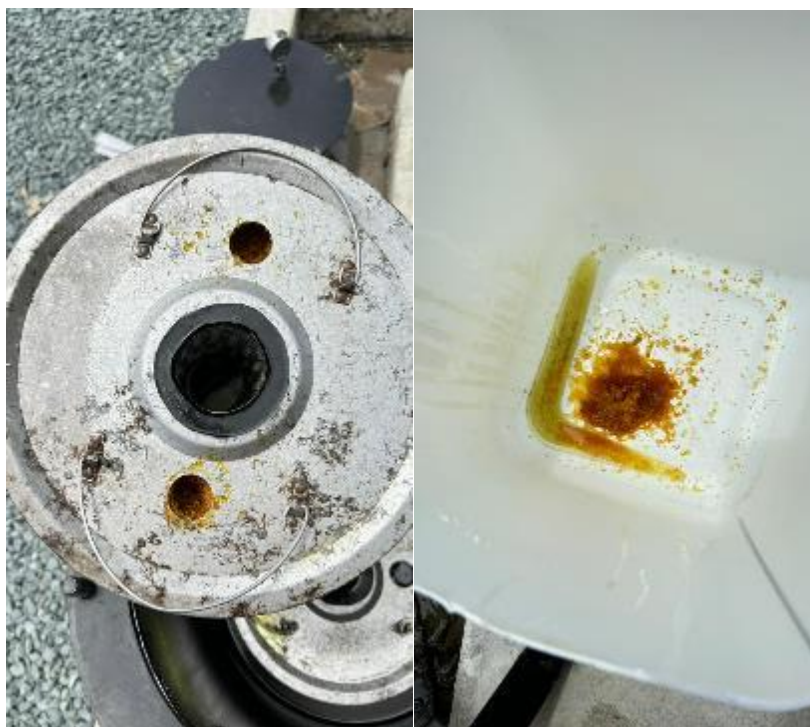
Figura 39.- Cambio de la sílice gel de los filtros
