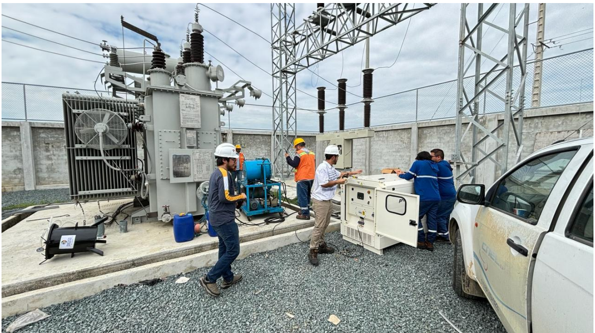
Instalación de un generador eléctrico que permitirá el funcionamiento del sistema y ayudará a evaluar la eficiencia del filtro
