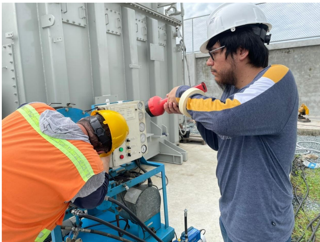
Figura 69.- Observando la cantidad de aceite dieléctrico dentro de la máquina de termovació
