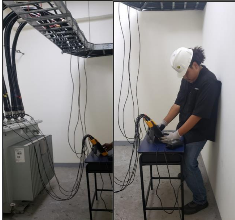
Figura 45. Ingreso al curto de transformador para instalación del equipo de medición Fluke 438 II.
