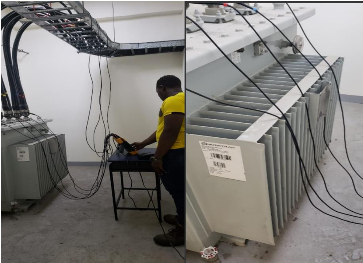
Figura 23. Cuarto de transformador Edificio E, Universidad Politécnica Salesiana, sede Guayaquil.
