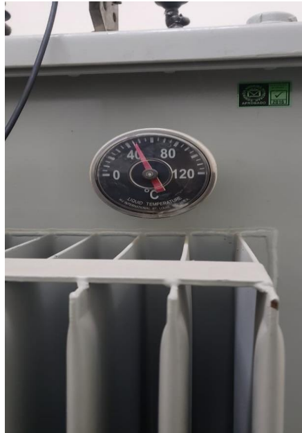
Figura 43. Termostato del transformador de 750 KVA del edificio E Universidad Politécnica Salesiana.
