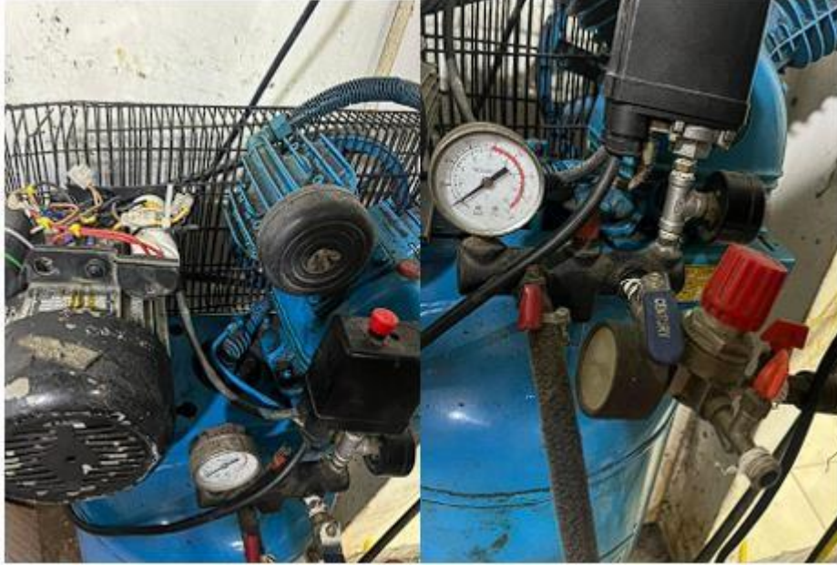
Figura 33. Sistema de aire comprimido en mal estado
