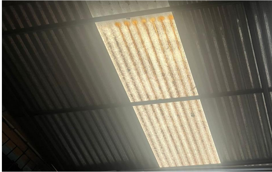
Figura 34. Única área de techado traslucido en mal estado
