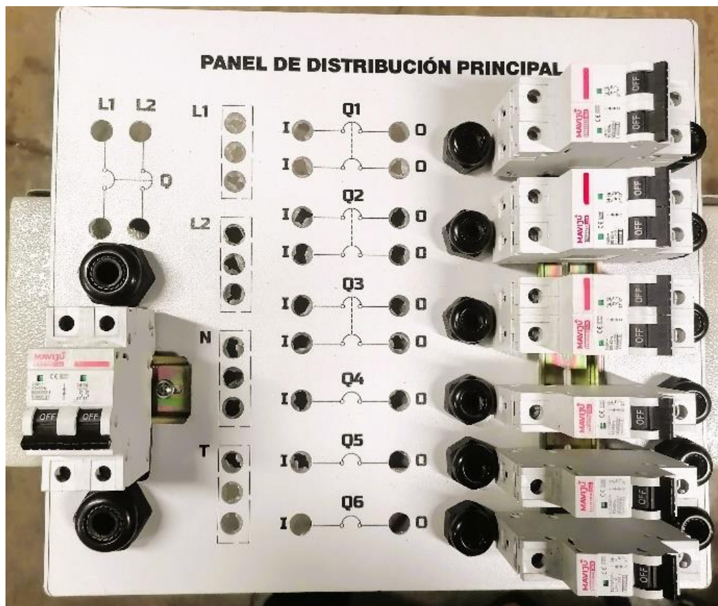
Figura 59. Montaje de disyuntores termo magnéticos en lámina de panel de distribución
