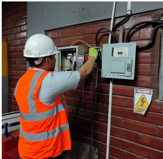
Figura 10. Mantenimiento en instalaciones eléctricas residenciales
