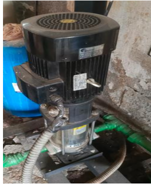
Figura 13. Bomba de agua en el HAIAM.
