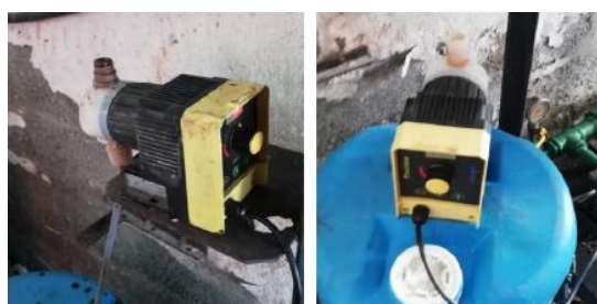
Figura 27. Dosificadora de químicos para una caldera Pirotubular.
