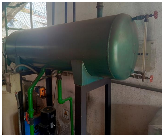
Figura 11. Tanque de condensado en el HAIAM. Fuente. Elaboración Propia.
