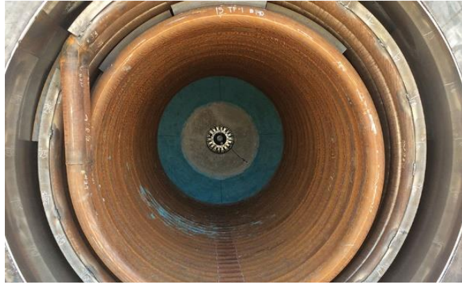
Figura 7. Hogar de una caldera industrial [18].
