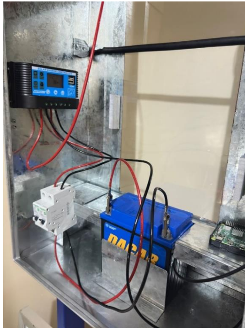
Figura 40 Conexiones internas de elementos eléctricos
