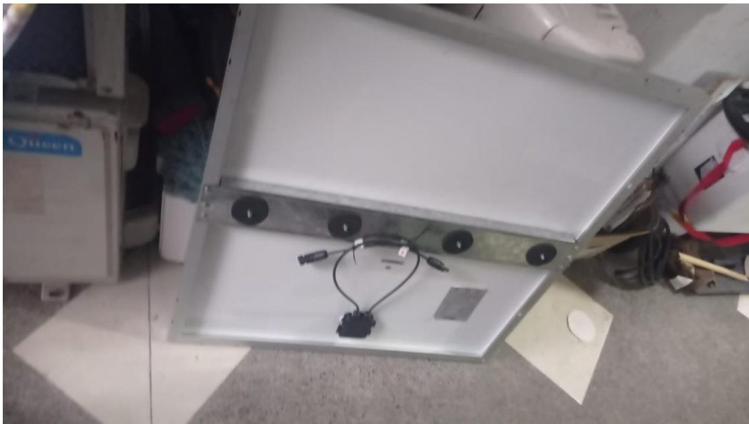
Figura 19 Estructura de soporte para panel solar
