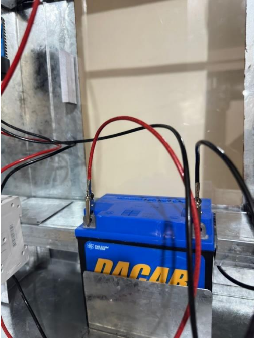
Figura 32 Bateria con conectores
