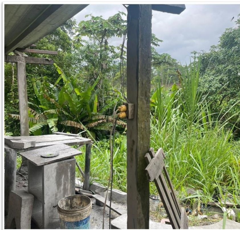
Figura 16. Cableado sin señalización.
