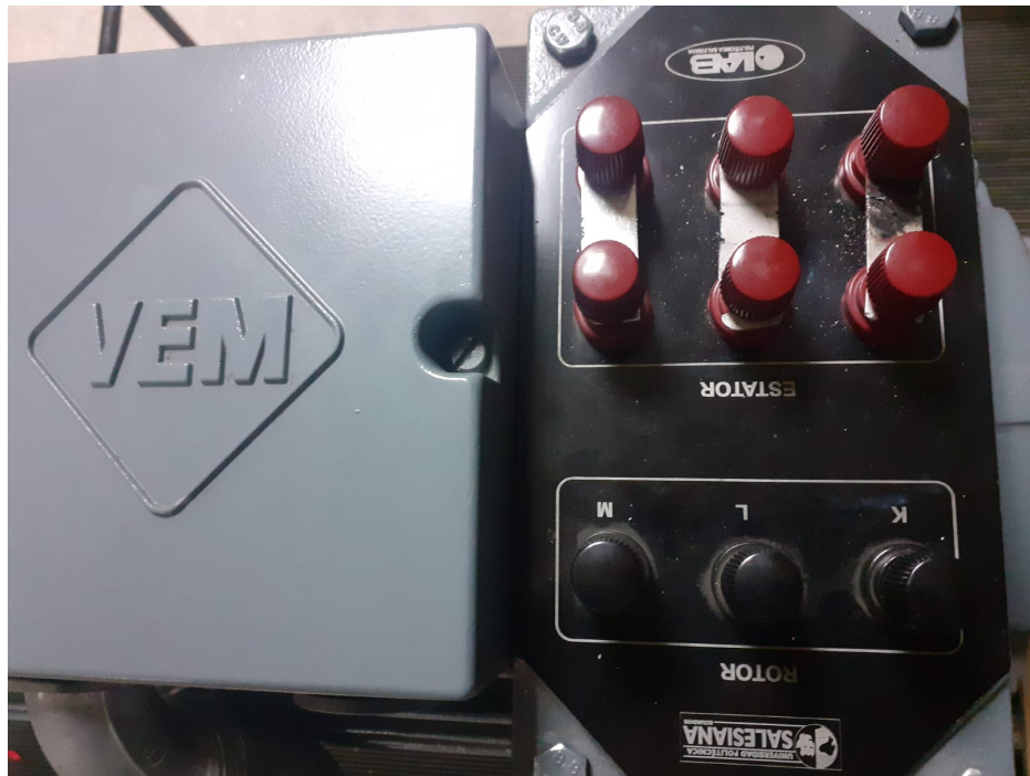
Figura 21: Borneras de conexión para el estator y rotor de la MI
