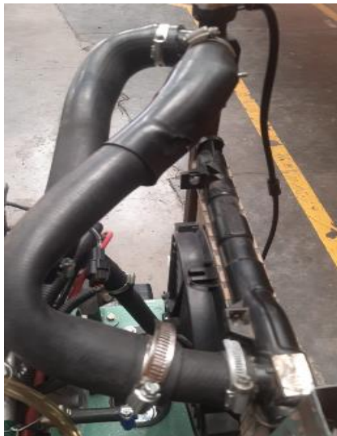
Figura 2.16 Mangueras de refrigeración
