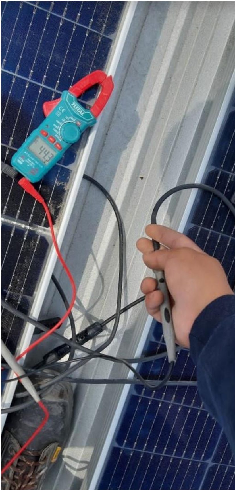
Anexo 10. Medición de voltaje de salida del panel.
