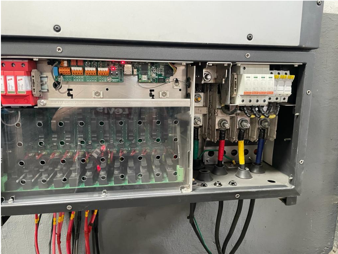
Anexo 5. Placa electrónica y protecciones del inversor.
