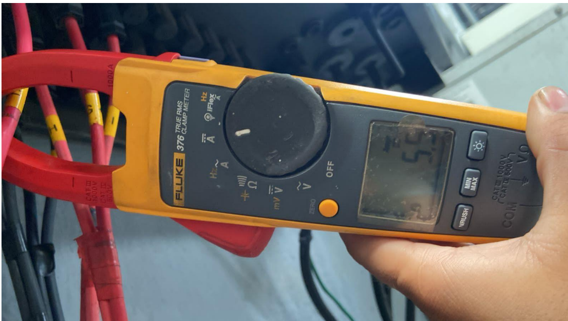
Anexo 6. Mediciones de corriente de cada circuito.
