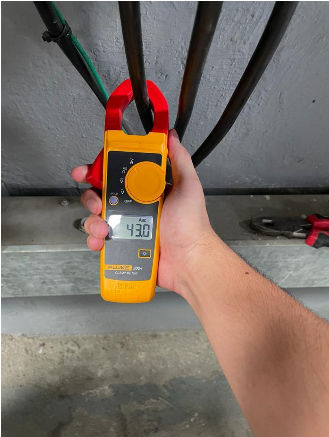
Anexo 7. Medición de corriente de salida línea 1
