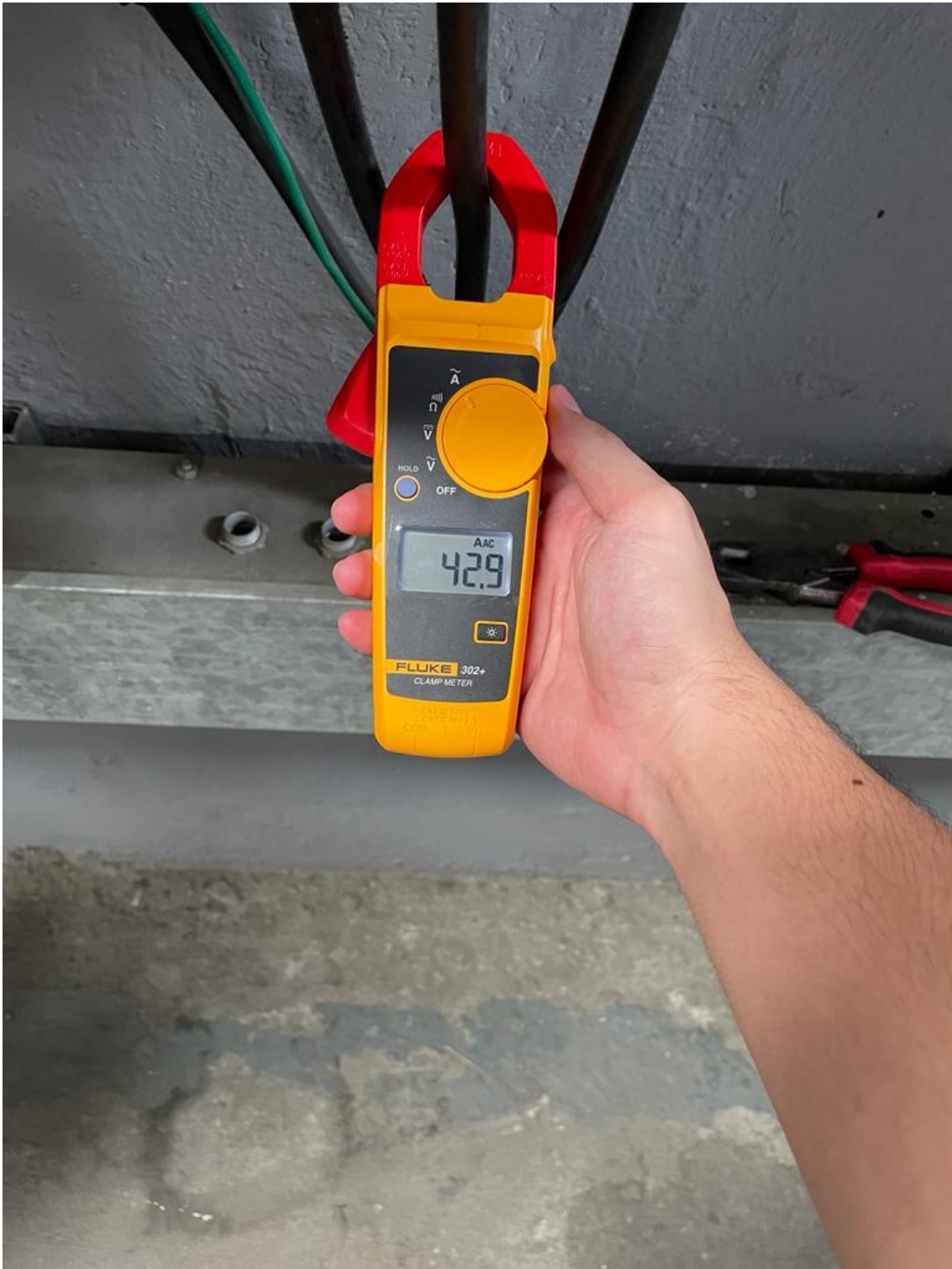
Anexo 8. Medición de corriente de salida línea 2
