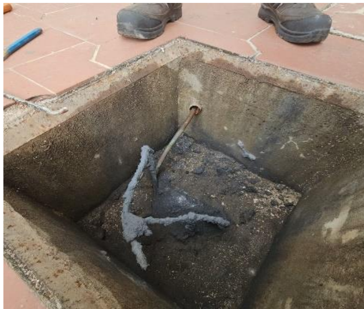
Figura 28. Sistema de puesta a tierra existente.
