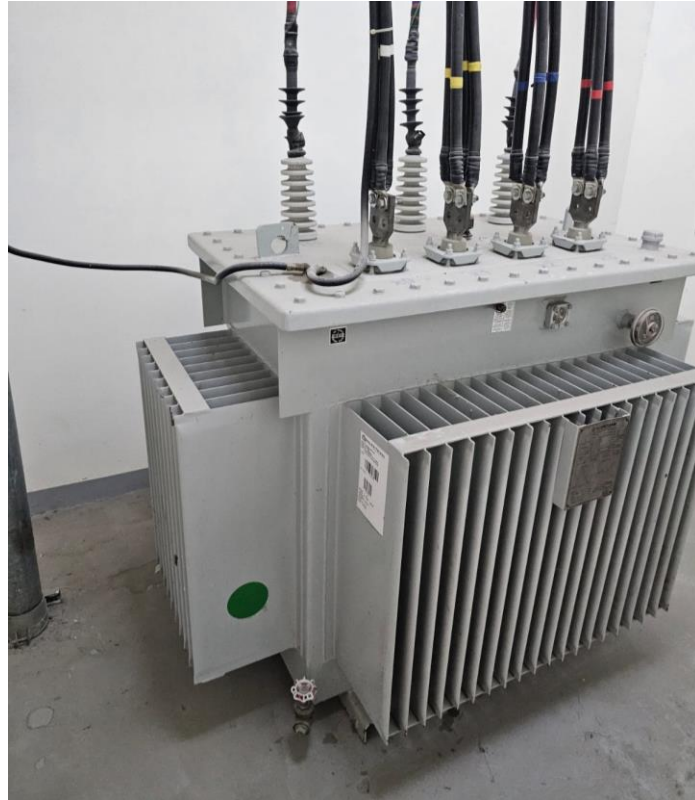
ANEXO 10. Transformador que se encuentra en el Bloque E
