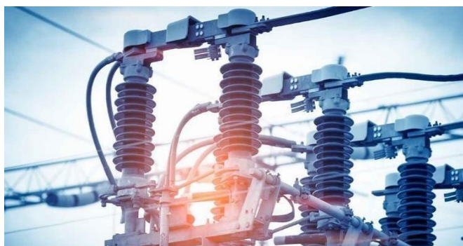
Figura 5. Transformador de corriente
