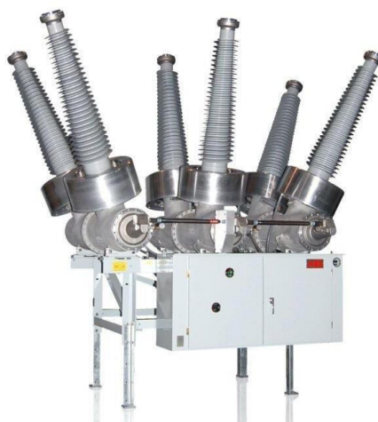
Figura 7. Disyuntor de 69 kV
