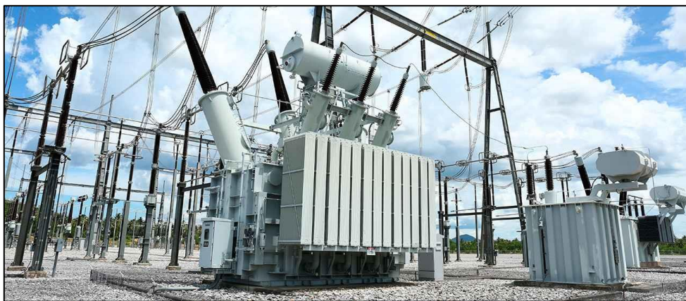
Figura 16.- Transformador de Potencia
