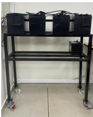
Figura 25. Banco de baterías de la UPS.
