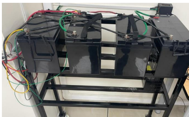
Figura 6. Banco de baterías de plomo ácido.
