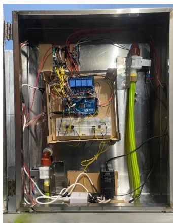
Figura 60. Tablero con circuitos y electroválvulas.
