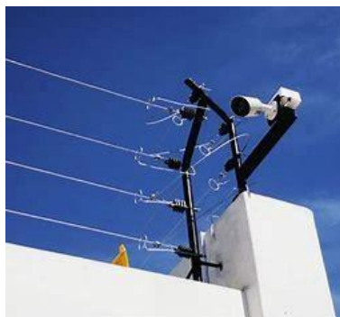
Nota. Cerco Eléctrico. Fuente: Lead. 2019.
