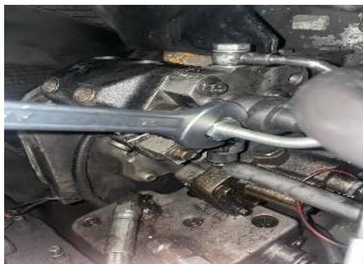
Figura 4.25: Suministro principal de la bomba
