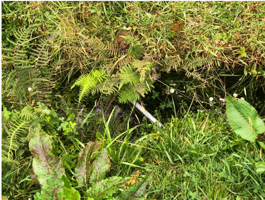
Conexiones de agua 1
