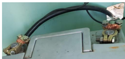
Figura 18. Cable de batería y bornes
