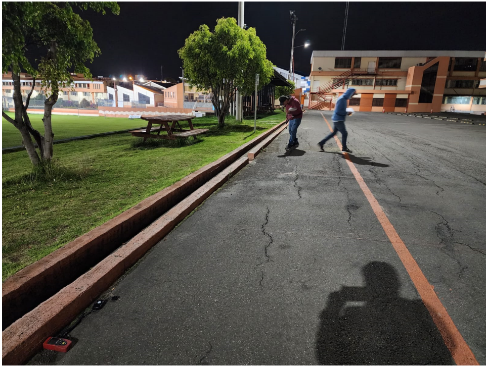
Figura 4.26: Vía junto a planta solar fotovoltaica de la UPS.[Fuente: Autores.]
