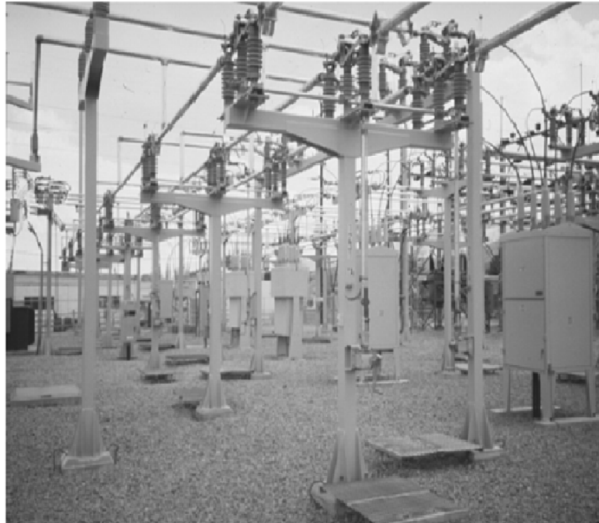
Figura 2.7: Subestación con Barras tipo Rígida. Fuente [20].
