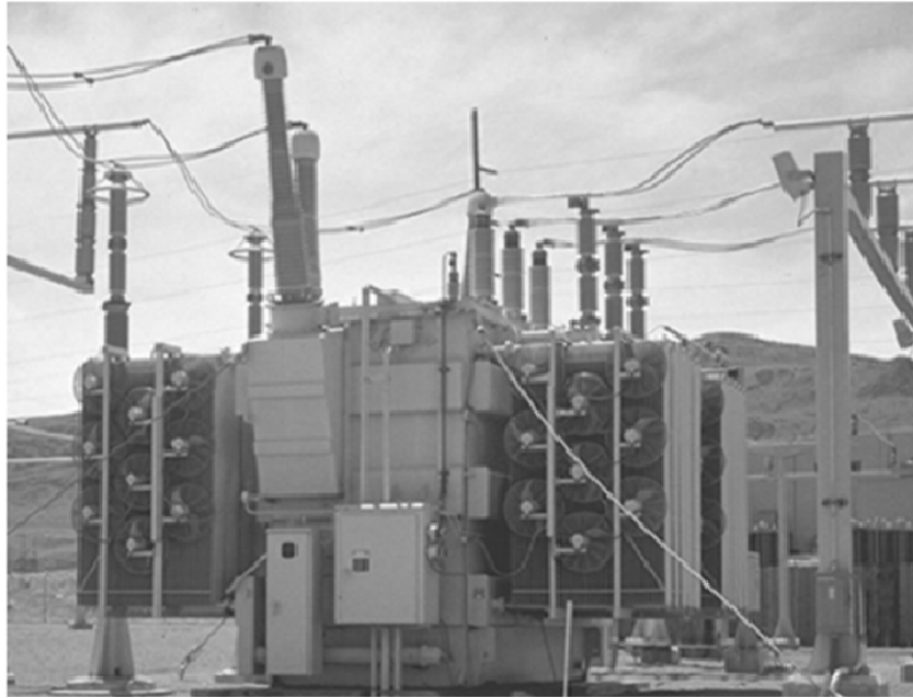
Figura 2.16: Transformador de Potencia. Fuente [20].
