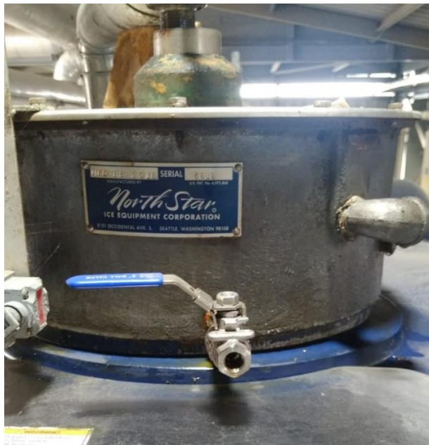
Fig. 7: Válvula purgadora de agua
