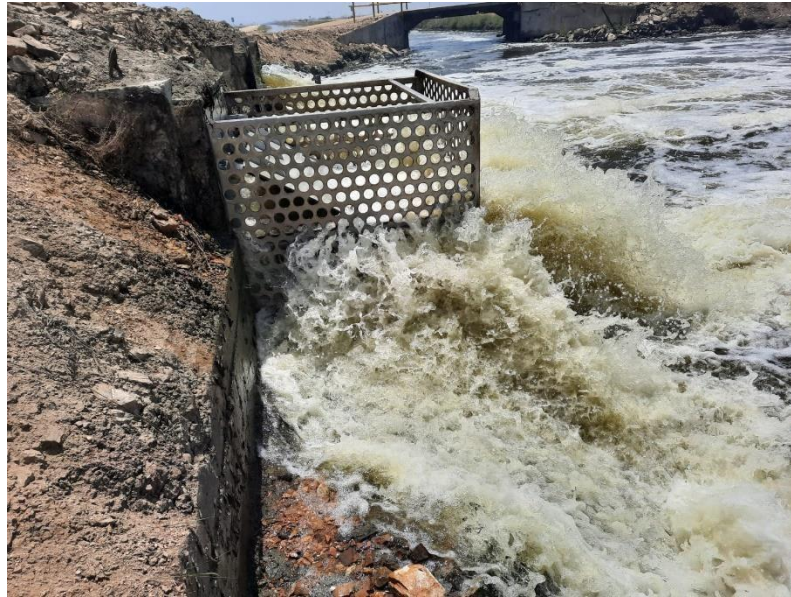
Figura 14.- Filtro tipo canasta empotrado en el ducto.
