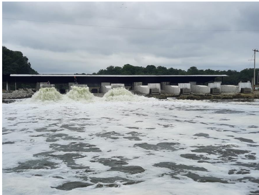
Figura 5.- Entrada y salida del agua por los ductos con filtrado
