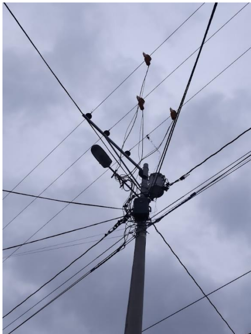
Figura 42. Ubicación del equipo – final de la troncal. Fuente: Autor.
