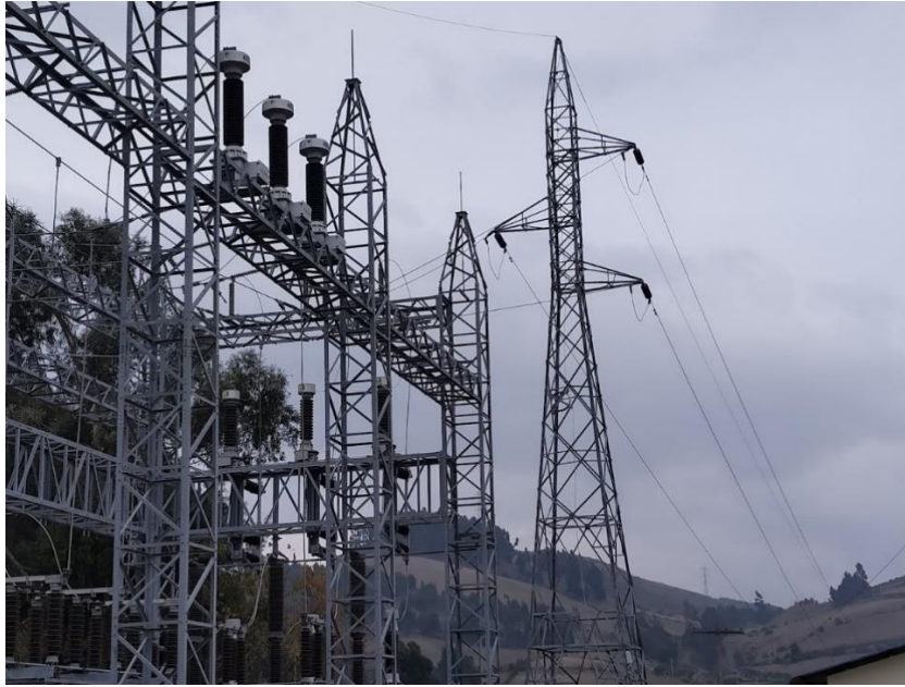
Figura 29. Pórtico de entrada en subtransmisión (69 kV) S/E #8 – Guamote. Fuente: Autor.
