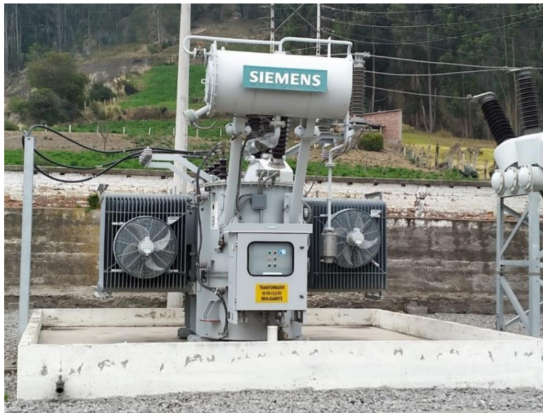
Figura 30. Transformador de potencia (5MVA) - S/E #8 – Guamate. Fuente: Autor.
