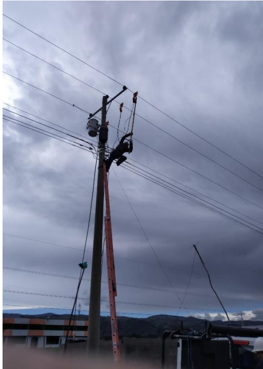
Figura 41. Ubicación del equipo – mitad de la troncal. Fuente: Autor.
