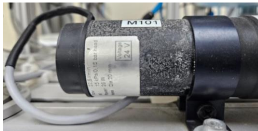
Figura 20. Bomba Scania 24V del módulo (Autores)
