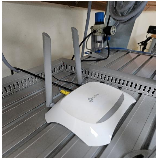
Figura 62. Conexión Tp-link (Autores)
