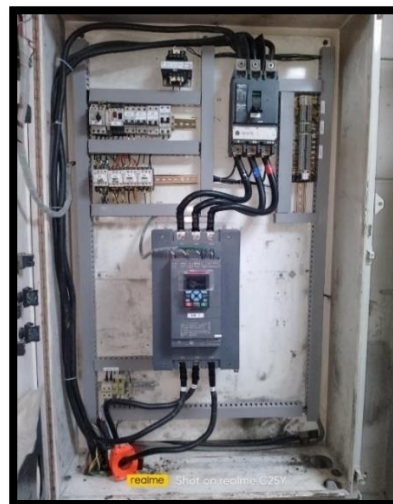
Figura 42. Tablero de fuerza nuevo del “Molino Crusher” en el área de “Molino de Reciclaje”, fuente: Los Autores.
