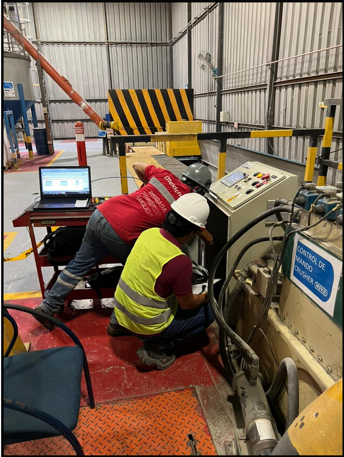
Figura 117. Reajuste de cableado en el tablero de control del “Molino Crusher” en el área de “Molino de Reciclaje”, fuente: Los Autores.
