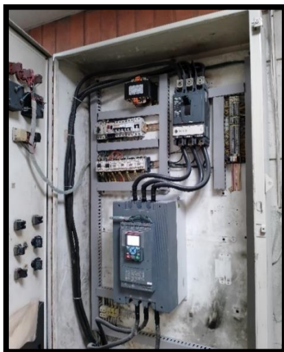
Figura 41. Tablero de fuerza antiguo del “Molino Crusher” en el área de “Molino de Reciclaje”, fuente: Los Autores.
