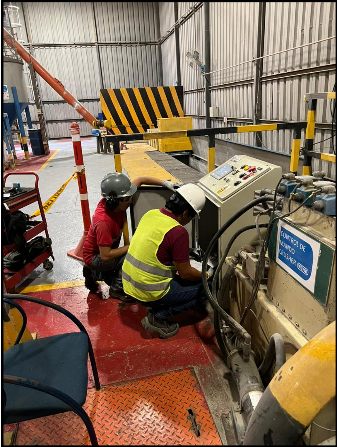
Figura 118. Enlistado de componentes del tablero de control del “Molino Crusher” en el área de “Molino de Reciclaje”, fuente: Los Autores.
