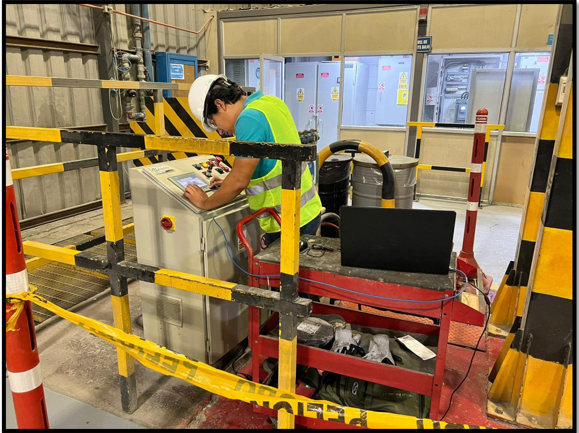
Figura 121. Probando el Sistema en modo automático del tablero de control del “Molino Crusher” en el área de “Molino de Reciclaje”, fuente: Los Autores.
