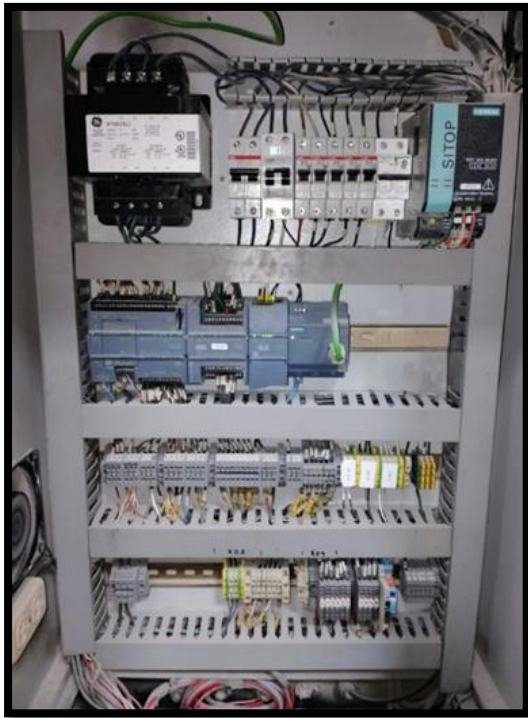
Figura 36. Tablero de control antiguo del “Molino Crusher” en el área de “Molino de Reciclaje”, fuente: Los Autores.
