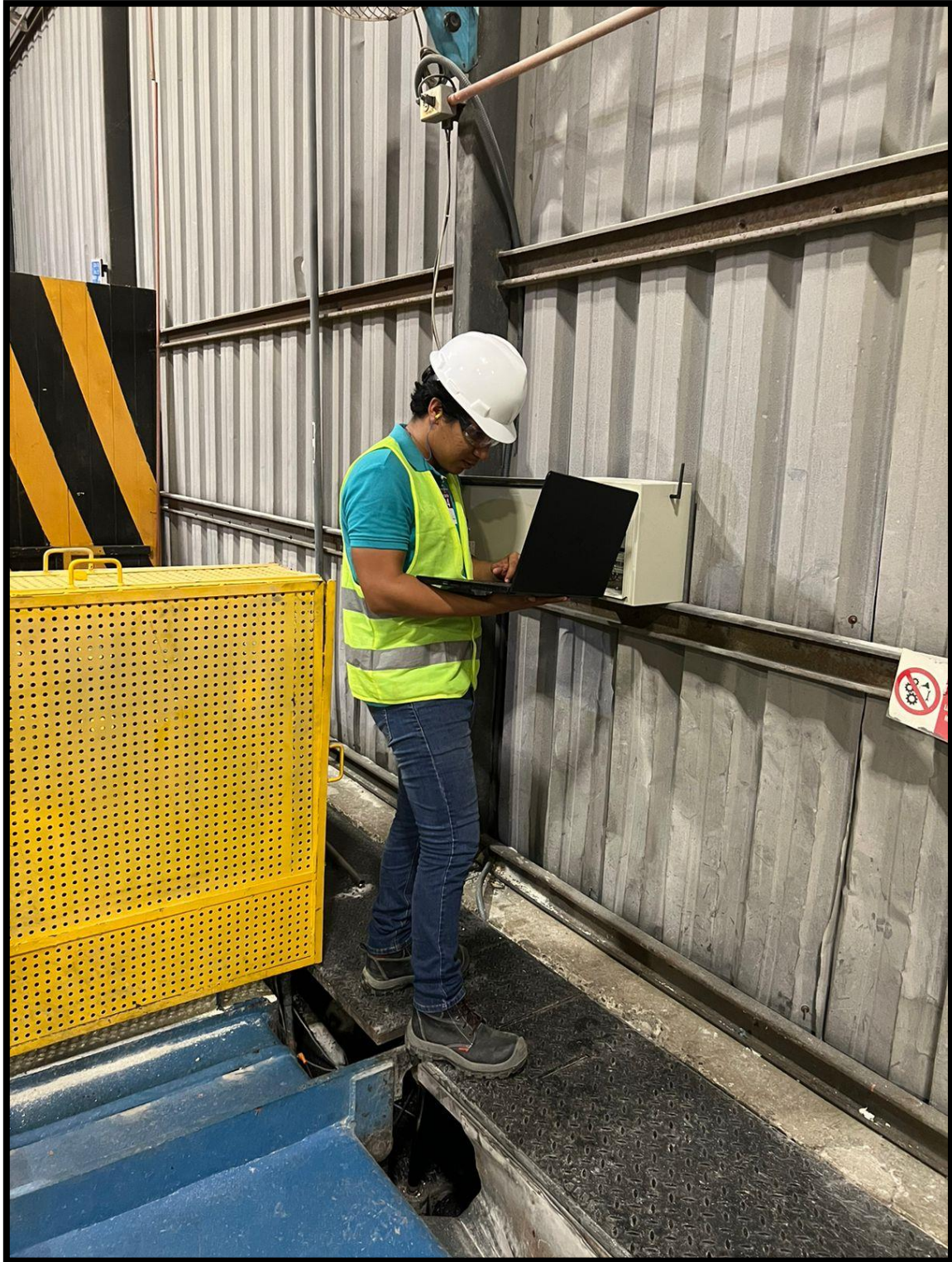
Figura 119. Programación en el tablero de control para la IoT en el motor del “Molino Crusher” en el área de “Molino de Reciclaje”, fuente: Los Autores.
