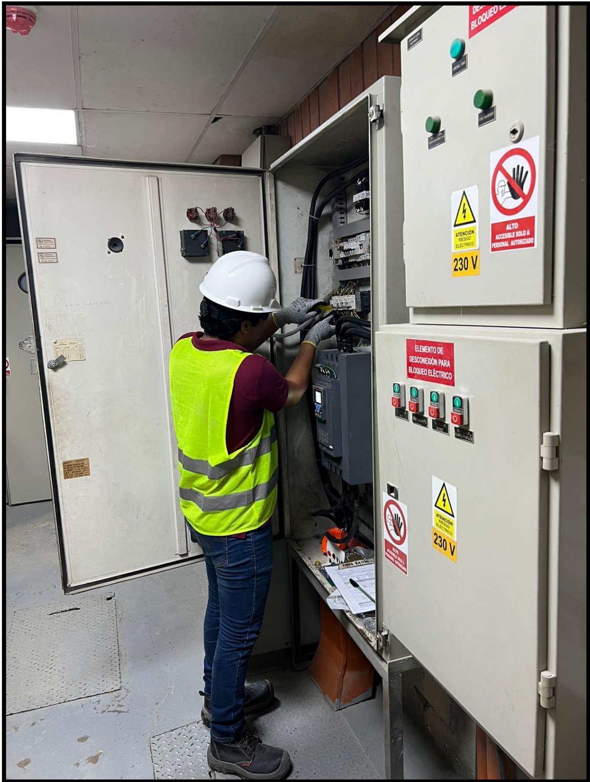
Figura 120. Cableado de señales al PLC del tablero de fuerza del “Molino Crusher” en el área de “Molino de Reciclaje”, fuente: Los Autores.
