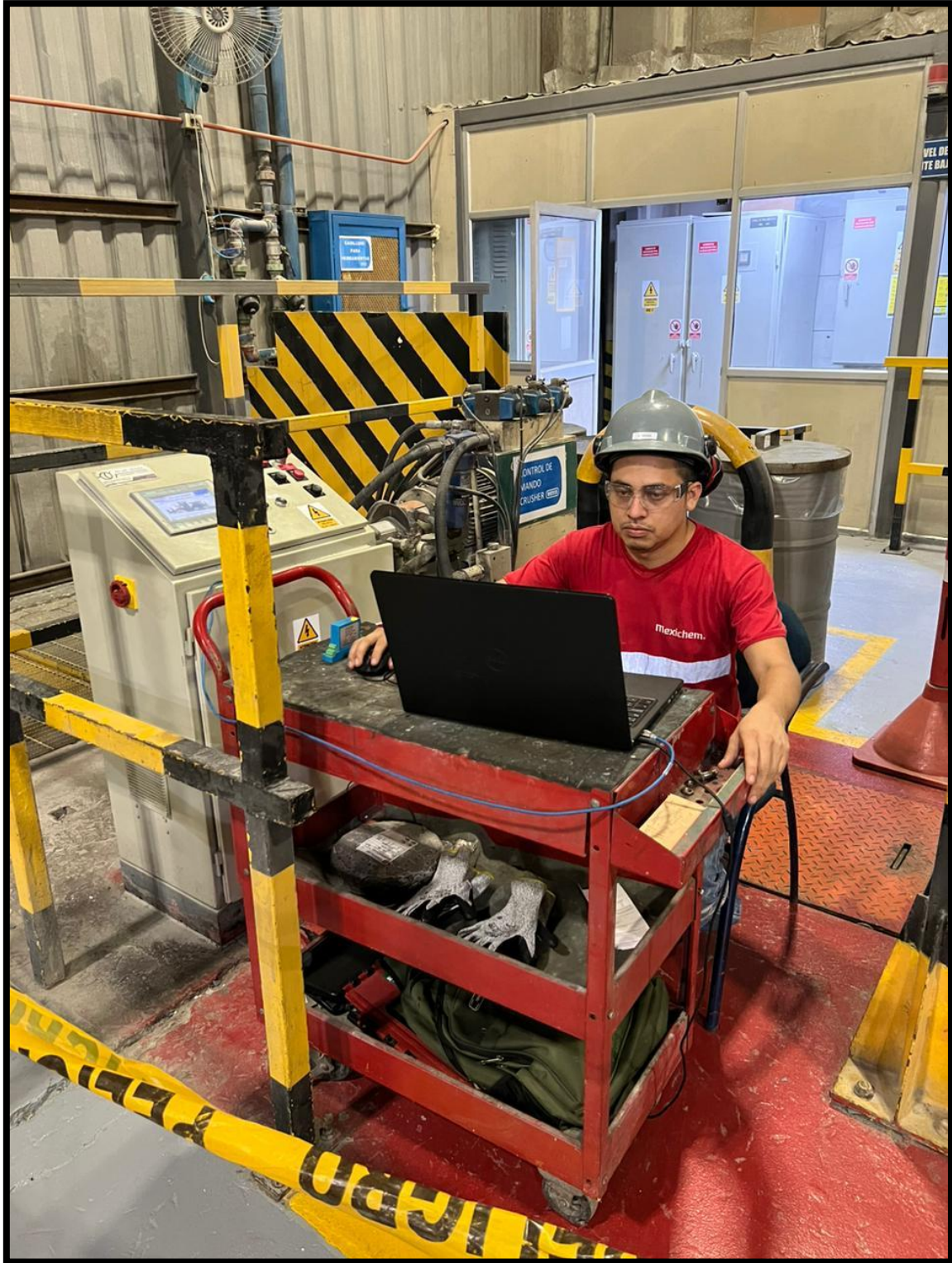
Figura 114. Programación del HMI al tablero de control del “Molino Crusher” en el área de “Molino de Reciclaje”, fuente: Los Autores.
