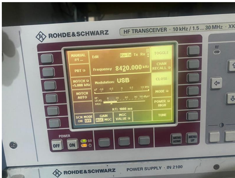
Figura 1. Equipo HF ubicado en la base naval San Cristóbal.
