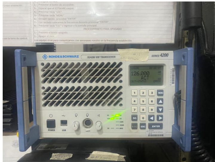
Figura 2. Equipo de frecuencia muy alta. Fuente: Autor propio.
