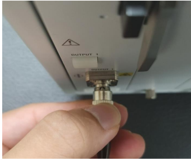
Figura 75. Instalación de la fibra óptica mono modo al puerto FC (Ferrule Connector/Conector Ferrule) del módulo YOKOGAWA AQ2200-131. Fuente: [8] [17].
