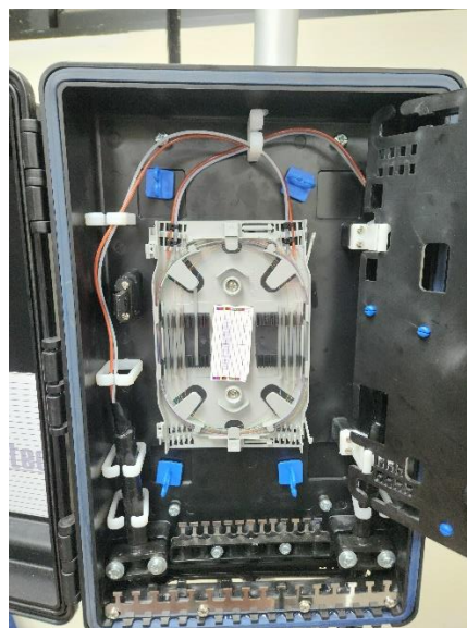
Figura 38. Caja de distribución óptica del laboratorio de comunicaciones ópticas. Fuente: [8].
