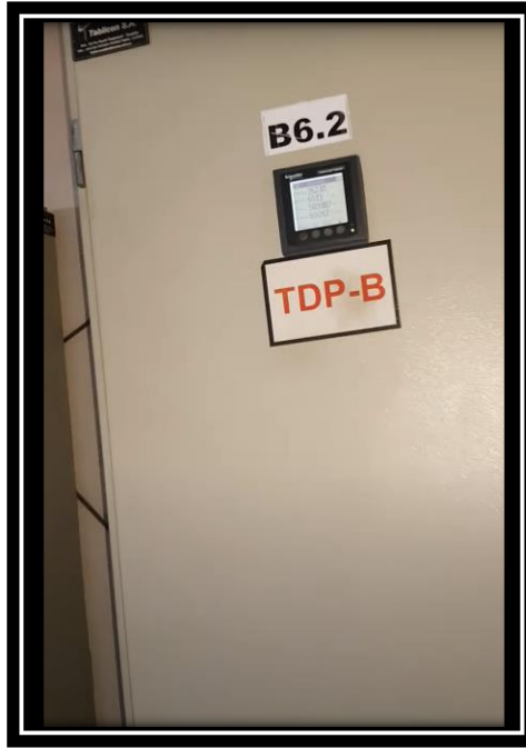
Figura 26 Tablero Alfa 2 B
