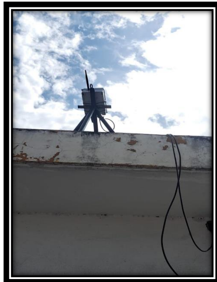
Figura 24 Módulo Xbee instalado sobre la superficie del cuarto Reffer 2 alfa
