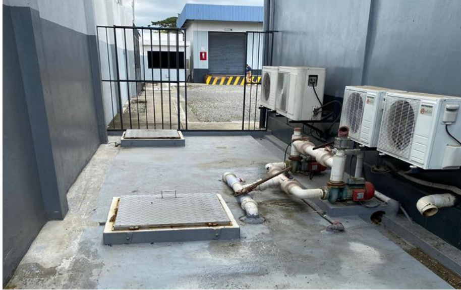
IMAGEN # 2 Cisternas de agua
