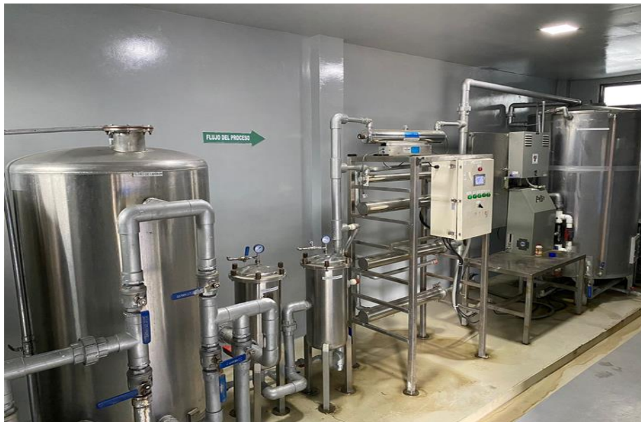
IMAGEN # 3 Máquinas purificadoras de agua.
