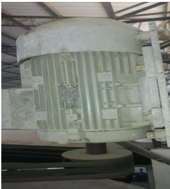
ANEXO 1: MOTOR ELECTRICO DEL REACTOR TANQUE EN AREA PRODUCCION
