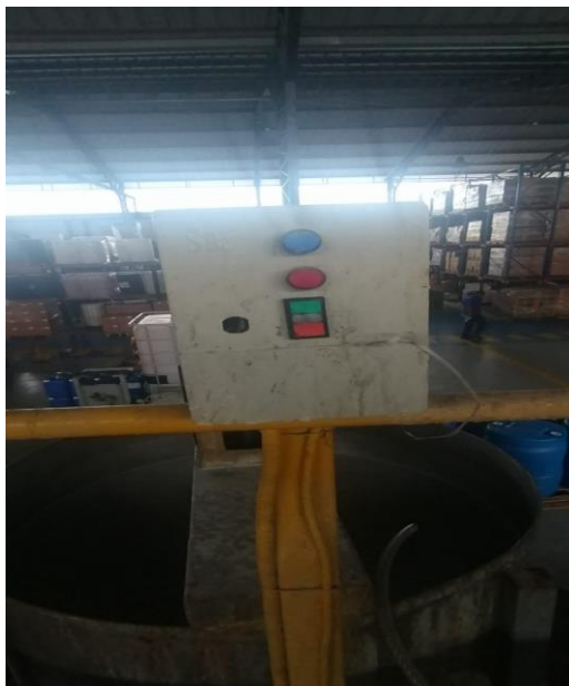
ANEXO 2: PANEL DE CONTROL ELECTRICO EN AREA DE PRODUCCION
