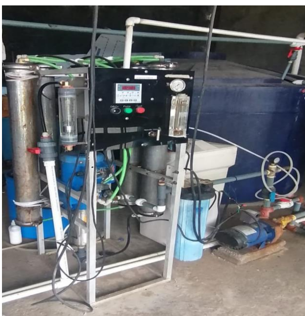
ANEXO 11: SISTEMAS DE OSMOSIS 1, BOMBA DE AGUA, MEMBRANAS PLASTICAS, PANEL DE CONTROL ELECTRICO
