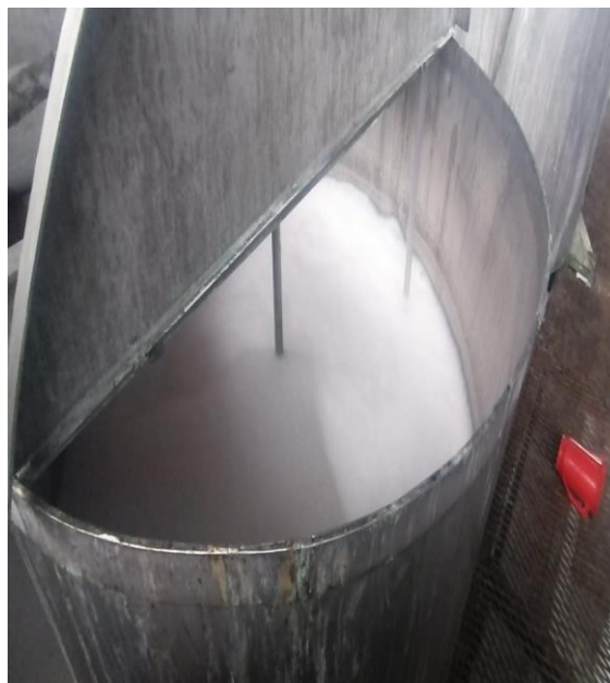
ANEXO 6: REACTOR TANQUE EN USO DE MEZCLAS QUIMICAS
