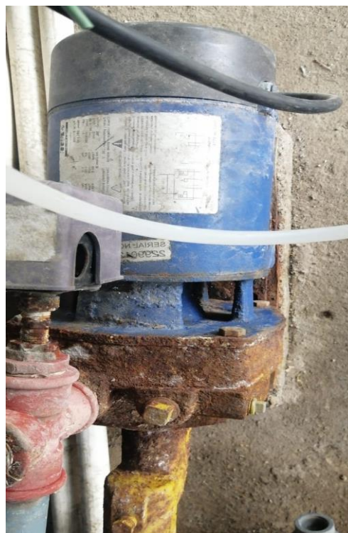
ANEXO 8: BOMBA DE AGUA CON OXIDACION, PERO EN USO
