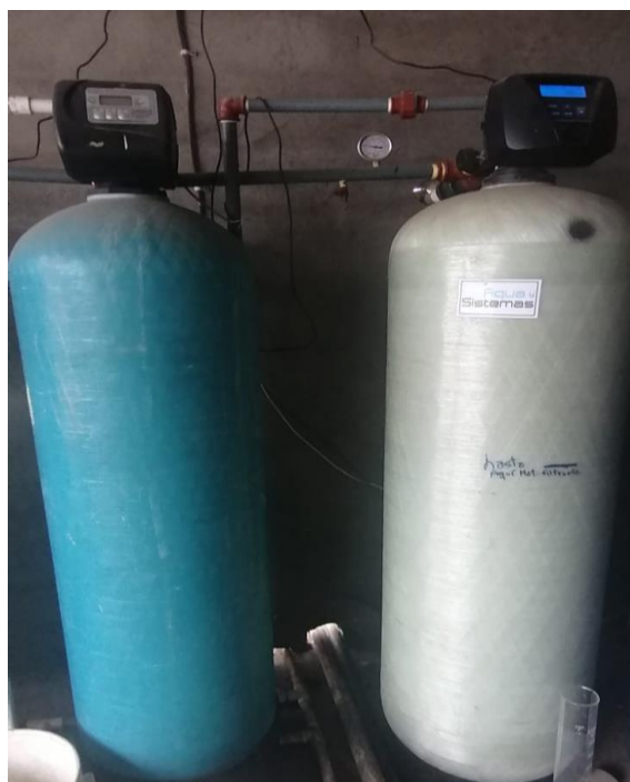
ANEXO 10: CABEZALES Y ABLANDADORES, EN USO EN PLANTA DE OSMOSIS
