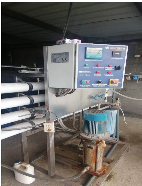
ANEXO 7: SISTEMA DE OSMOSIS 2, BOMBA DE AGUA, PRE FILTRO, MEMBRANAS PLASTICAS, PANEL DE CONTROL ELECTRICO
