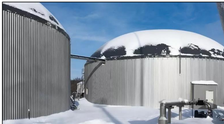
Figura 9. Planta de biogás en Voroshnevo
