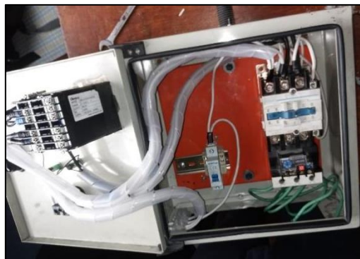
Fig. 65 Conexión sistema eléctrico
