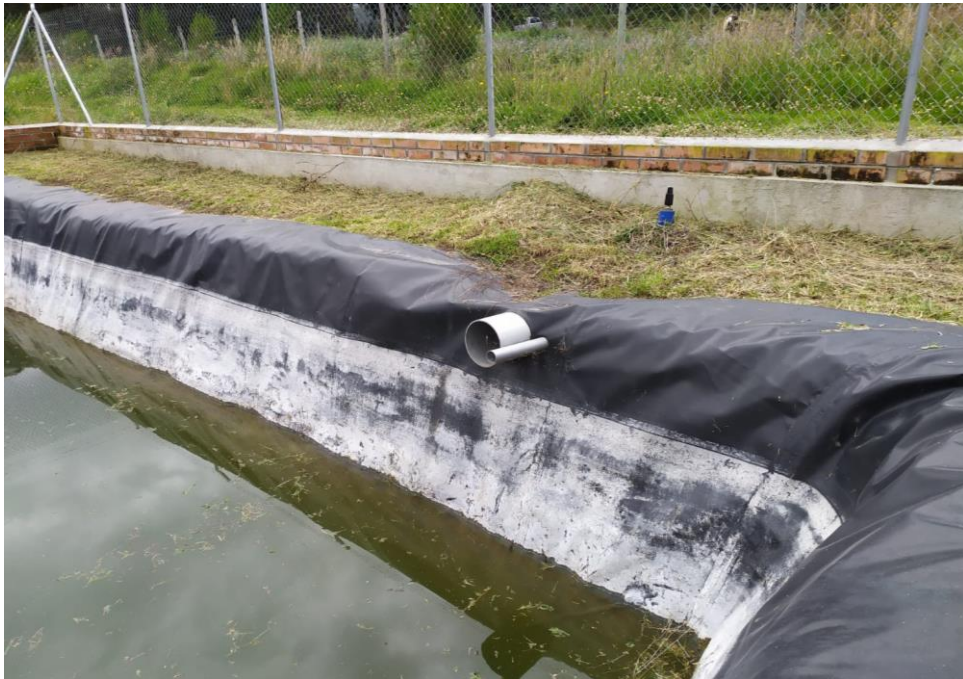
Figura 8. Tubería de PVC 250 mm para entrada a la turbina.
