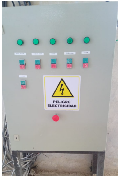
Figura 92. Tablero B por fuera [9]
