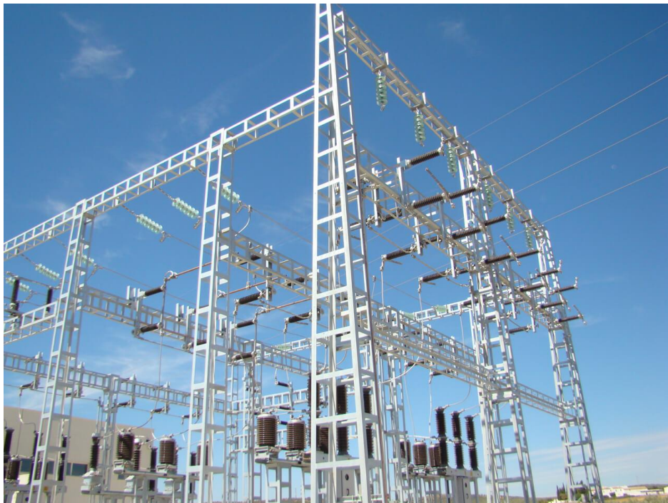
Figura 7.- Subestación de la Empresa Cartorama C. A.
