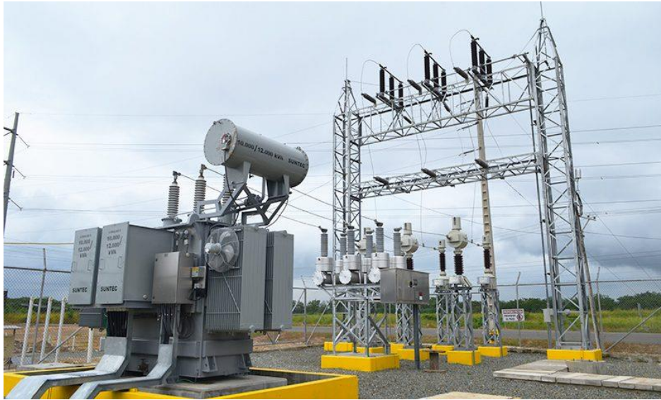
Figura 6.- Subestación de la empresa Cartorama C.A.
