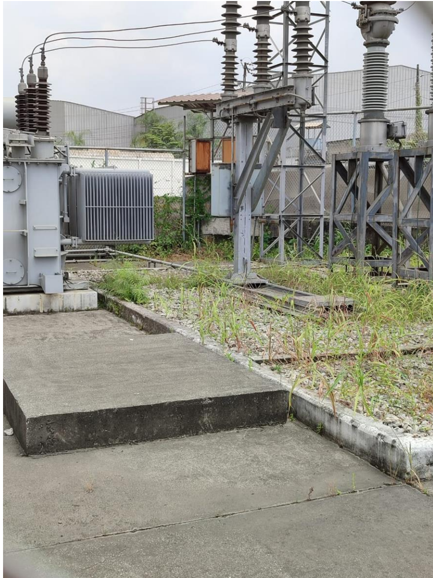
Terminales de 69KV
