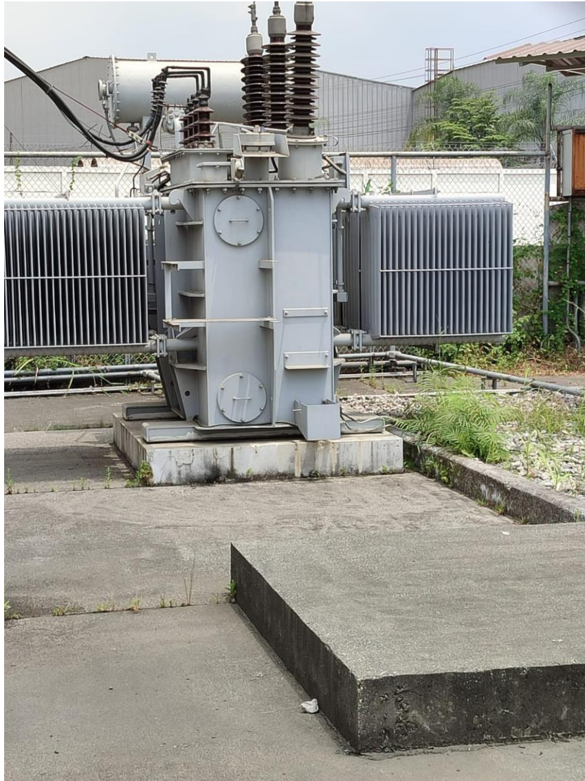
Vista lateral del transformador
