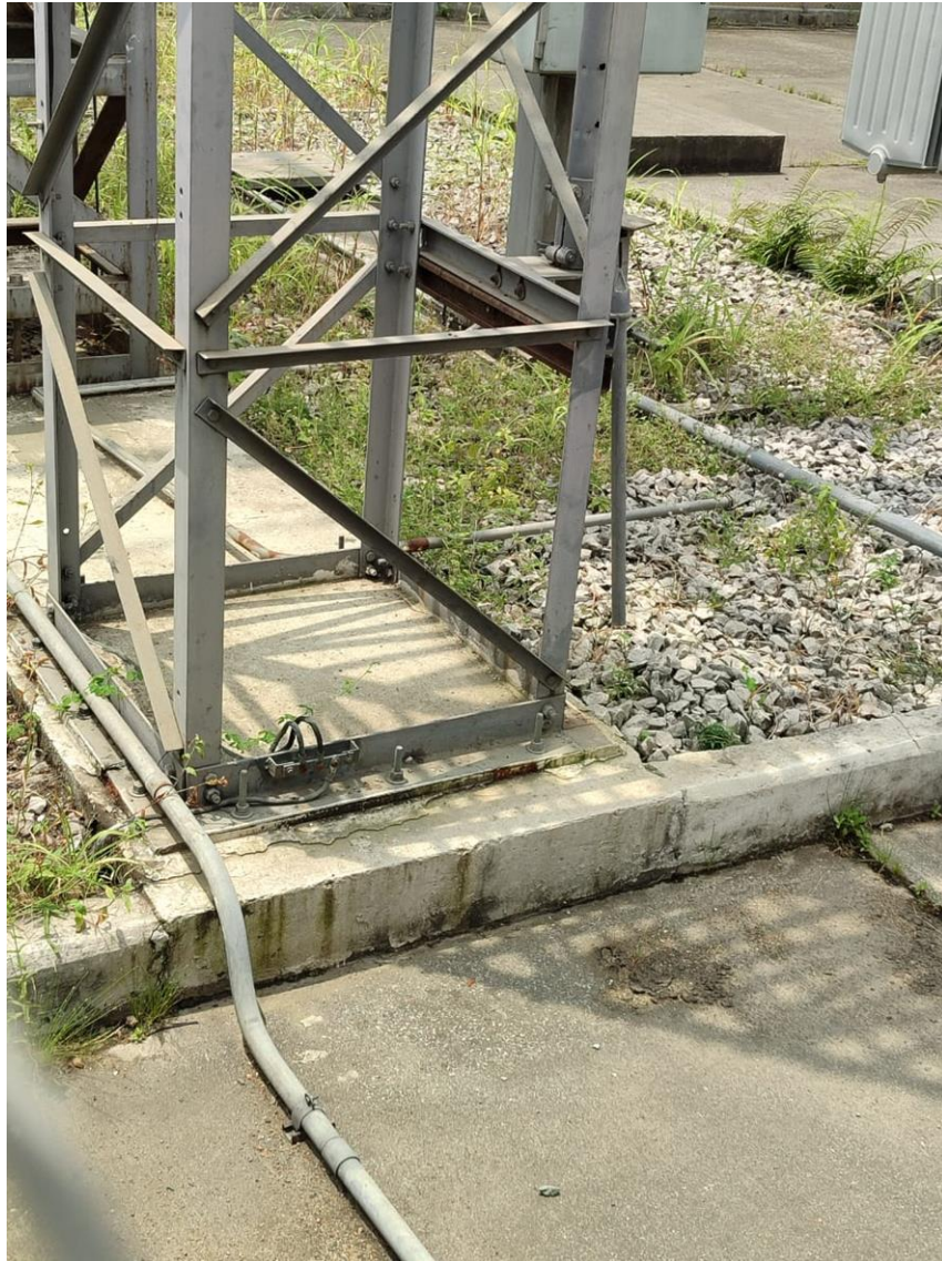
Puntos de conexiones de las mallas a tierra
