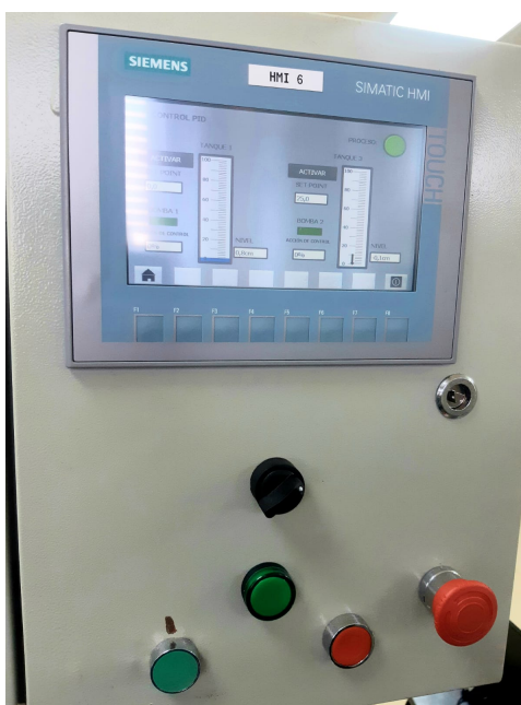
Figura 52. Parte frontal del tablero eléctrico
