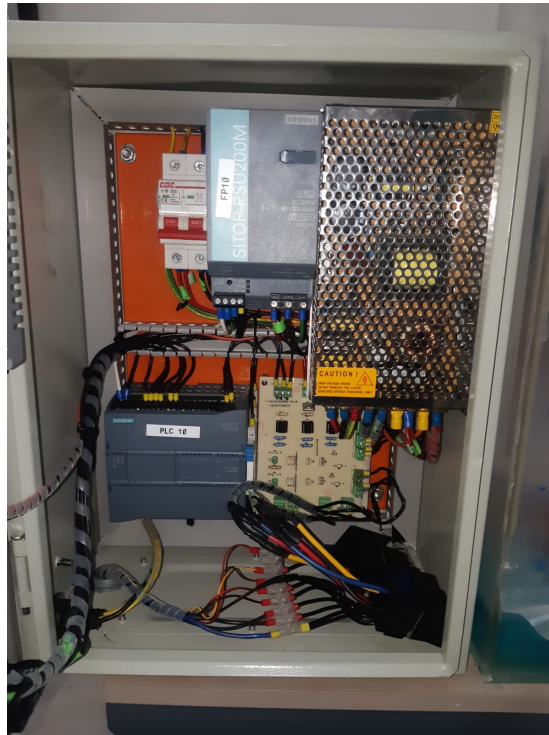
Figura 53. Conexiones internas del tablero eléctrico
