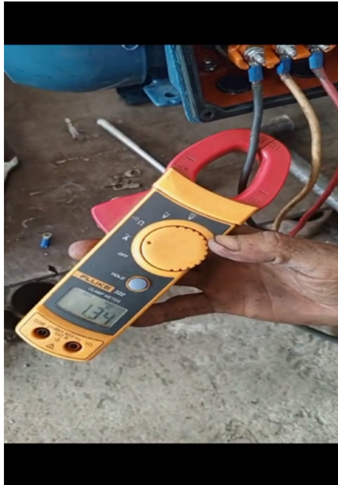
Figura 50. Medición de amperaje mezcladora 50
