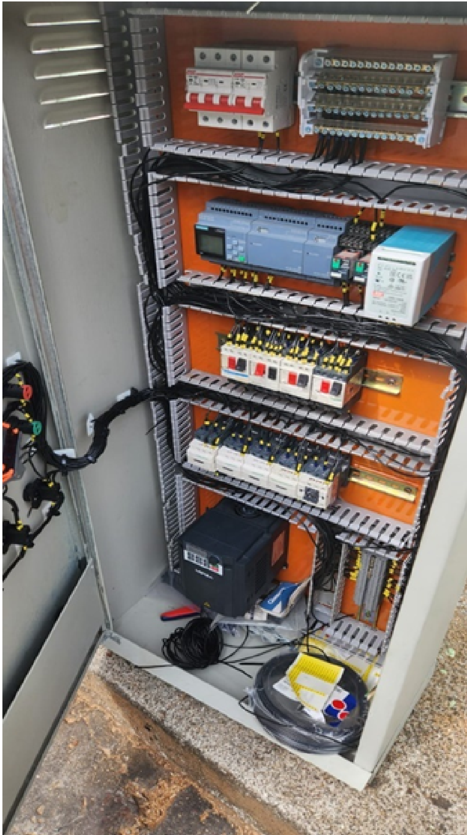
Figura 56. Cableado de tablero
