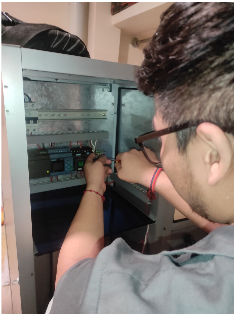
Figura 72. Montaje de PLC y Componentes
