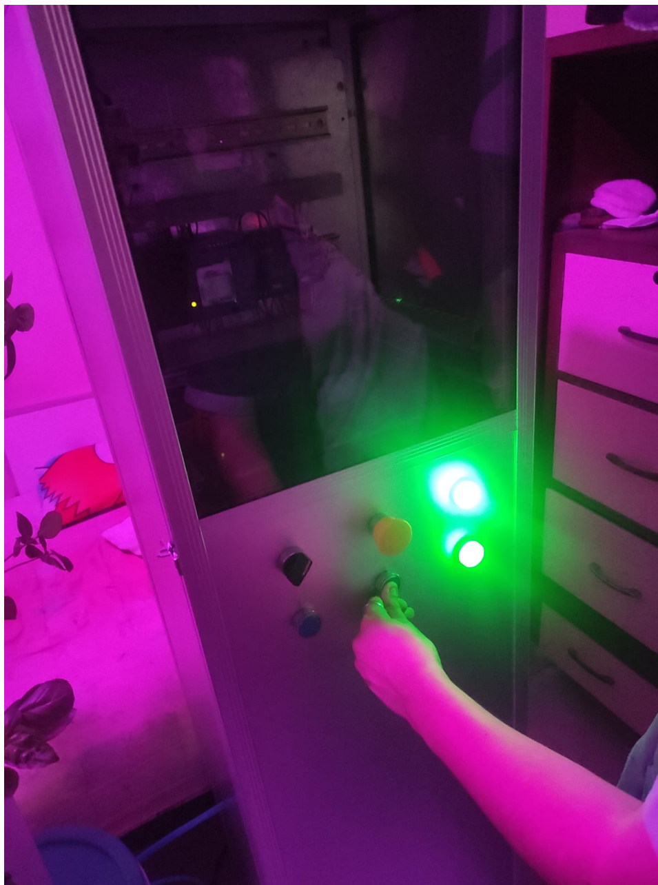
Figura 74. Pruebas de Funcionamiento
